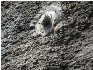
Entfernter Sicherungshaken in der Biwakwand
